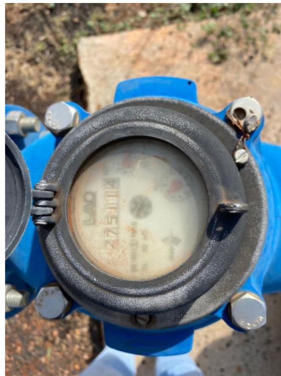
Figura 37 – Medição Macromedidor UP 08.
