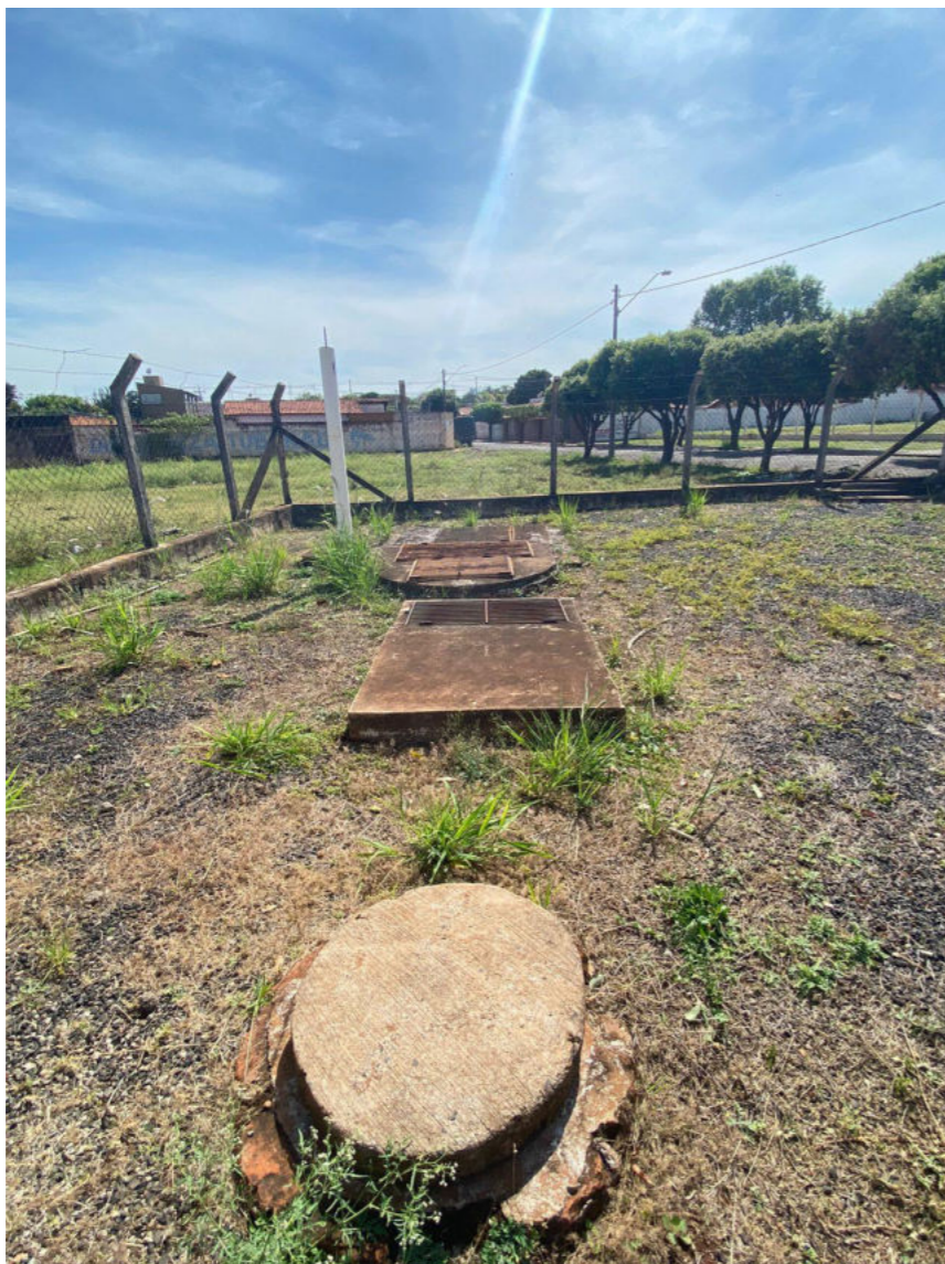
Figura 140 – Estação Elevatória de Esgoto Sete de Setembro.
