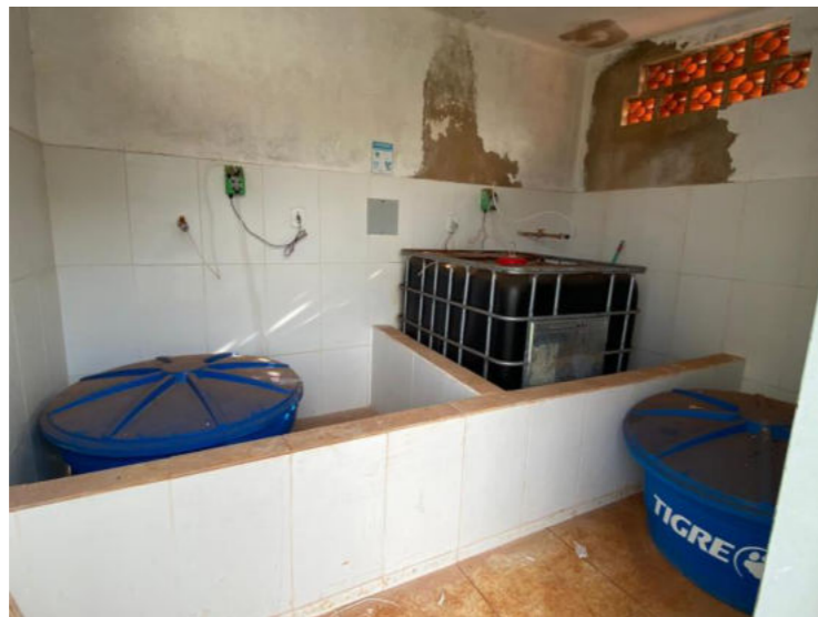
Figura 75 – Dosagem de cloro e flúor.
