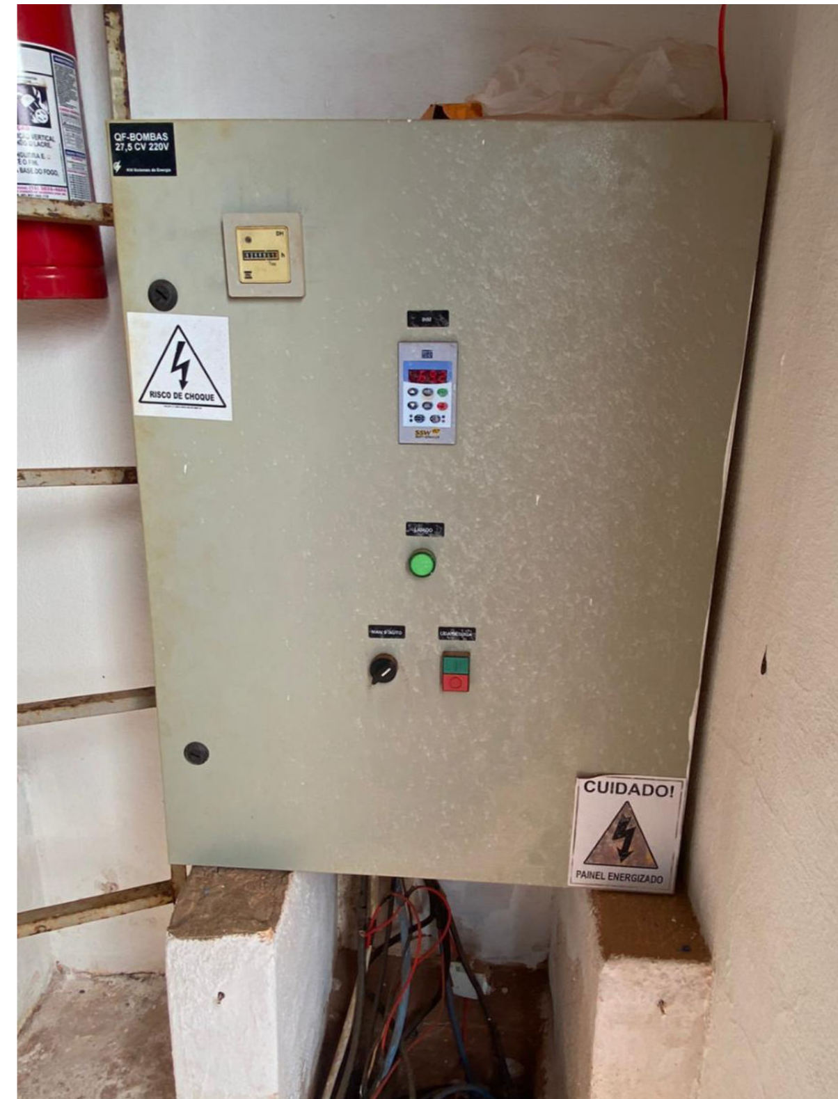
Figura 50 – Painel de comando.
