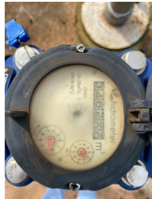
Figura 46 – Medição Macromedidor UP 09.
