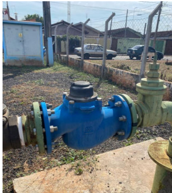
Figura 36 – Macromedidor Poço UP 08.
