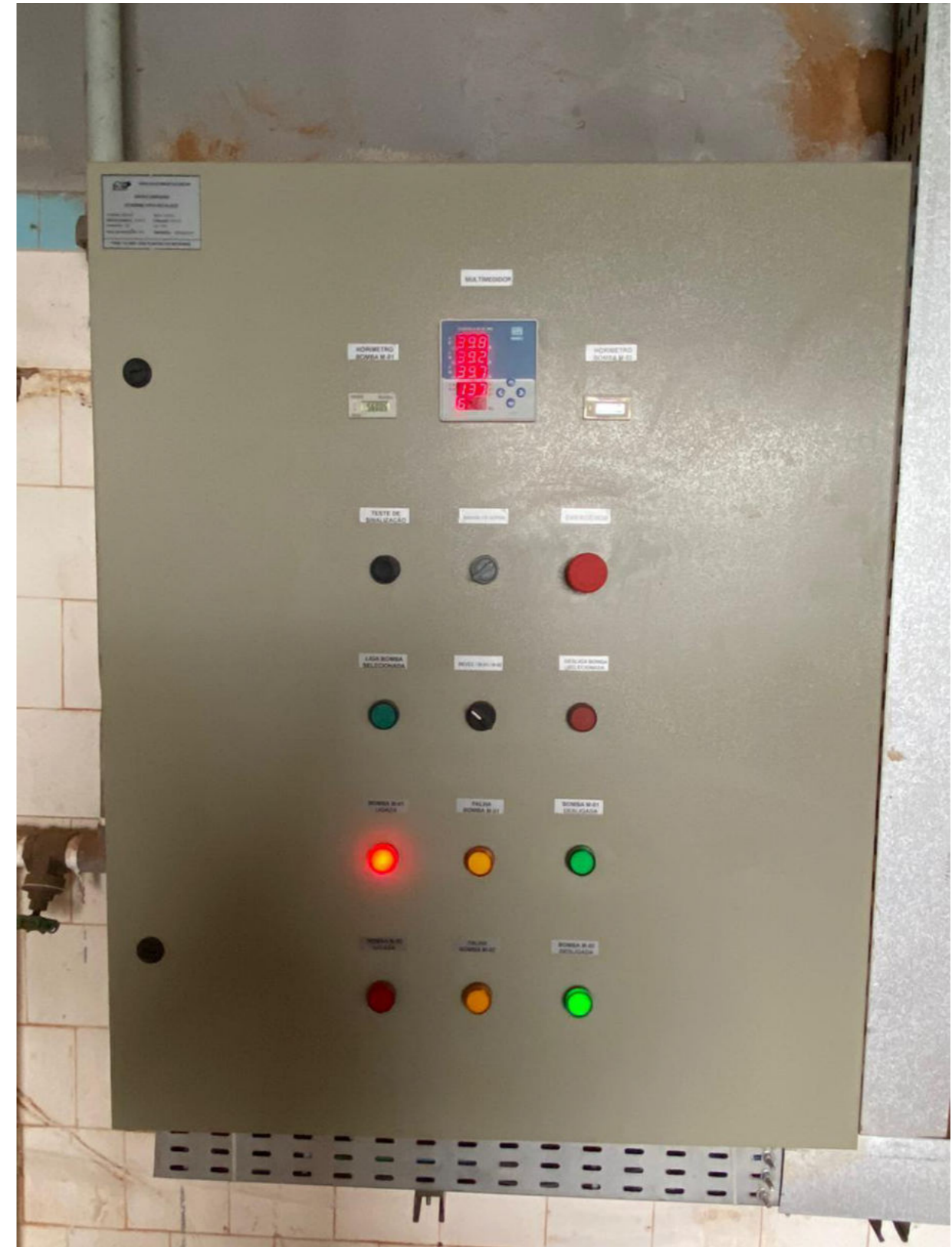
Figura 22 – Painel de comando.
