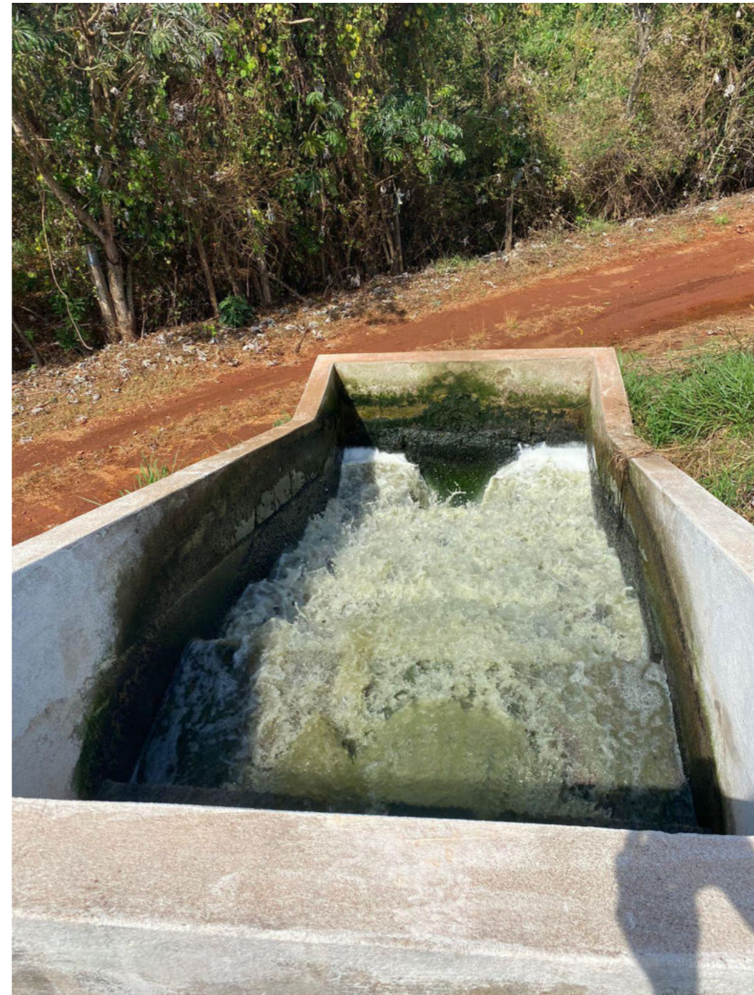
Figura 161 – Escada Aeradora da ETE Guará.
