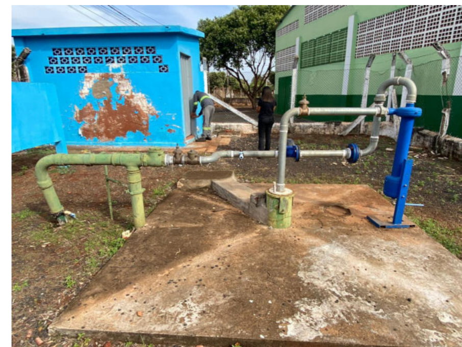
Figura 44 – Poço UP 09 com sistema de filtragem.
