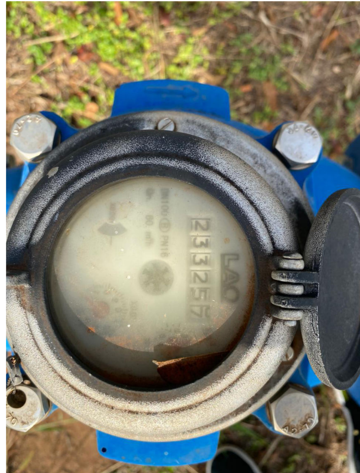
Figura 16 – Medição do Macromedidor Poço UP03.
