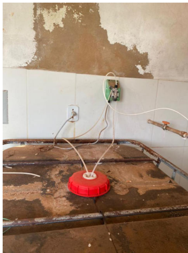
Figura 76 – Bomba dosadora de cloro.
