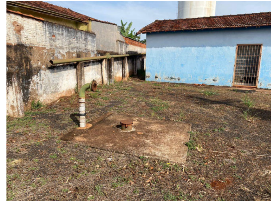
Figura 99 – Poço UP 02 desativado.
