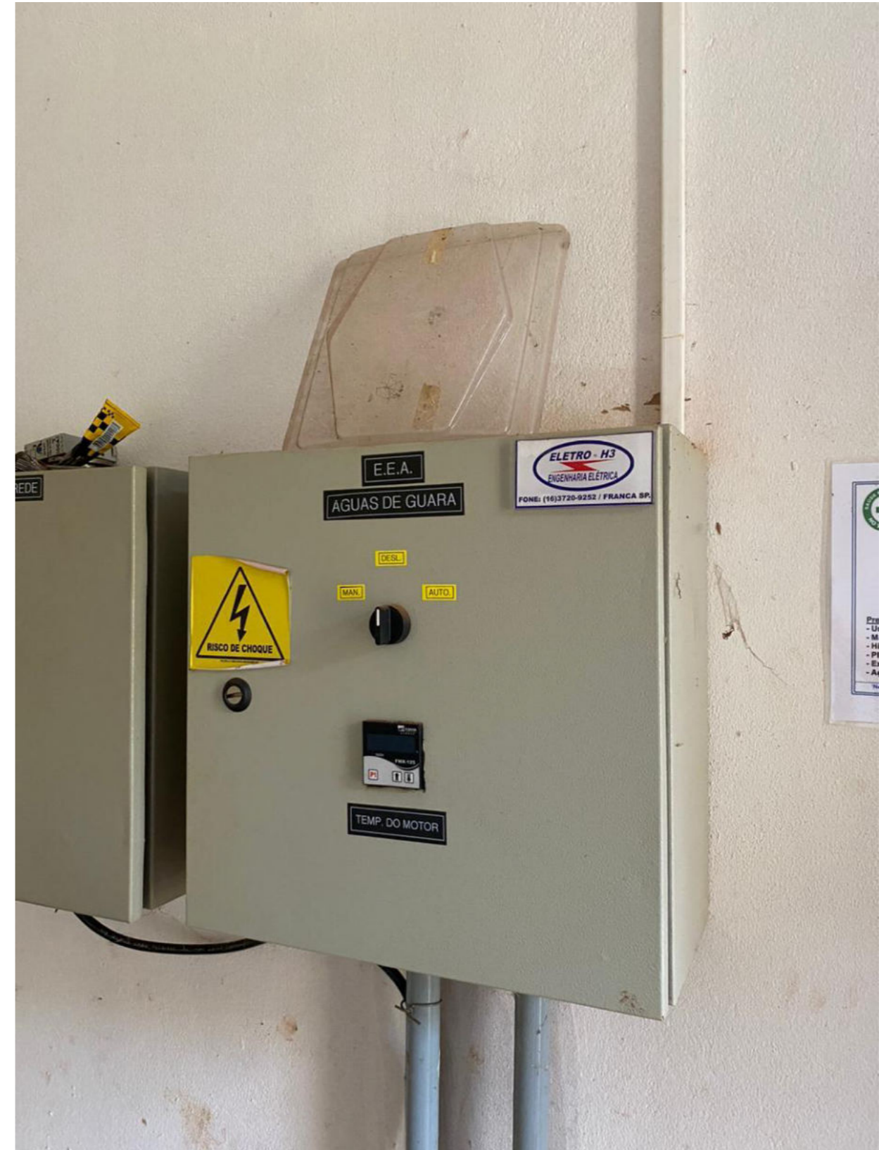
Figura 95 – Painel de comando.
