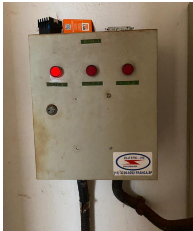
Figura 30 – Painel de comando.
