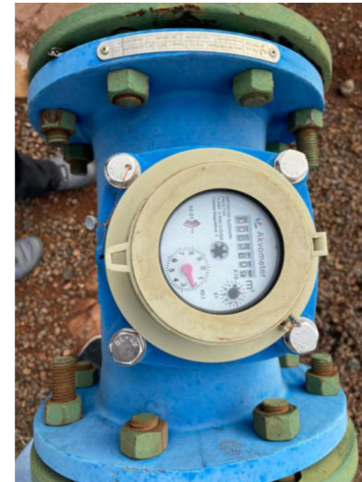
Figura 27 – Medição macromedidor UP06.
