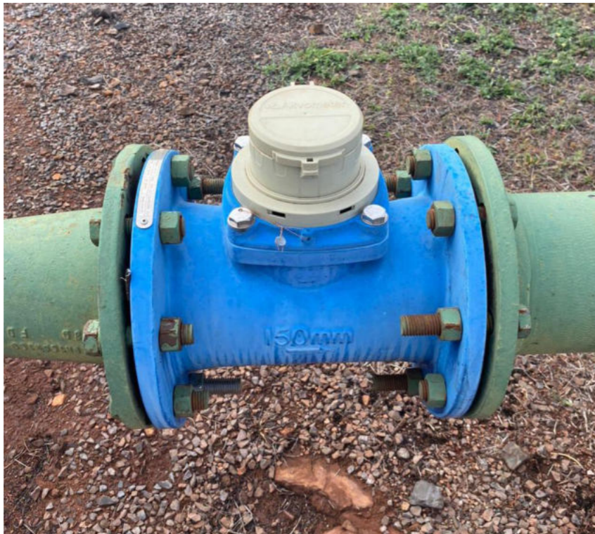
Figura 26 – Macromedidor Poço UP06.
