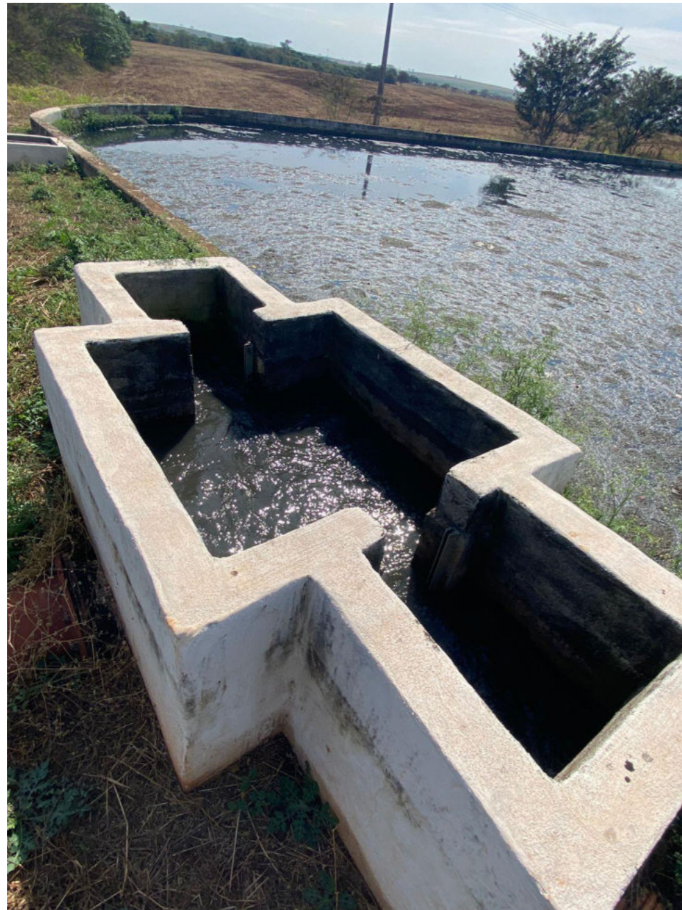
Figura 151 – Chegada do Efluente na Lagoa Anaeróbia.
