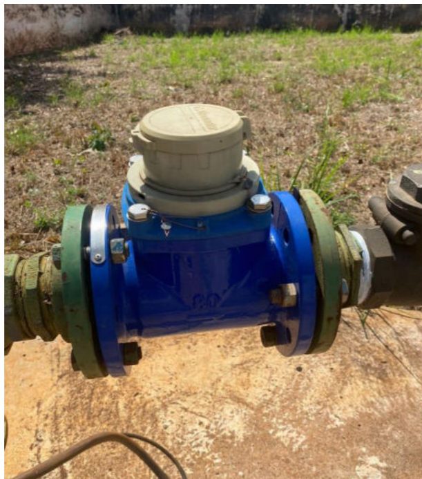
Figura 81 – Macromedidor UP Pioneiros.
