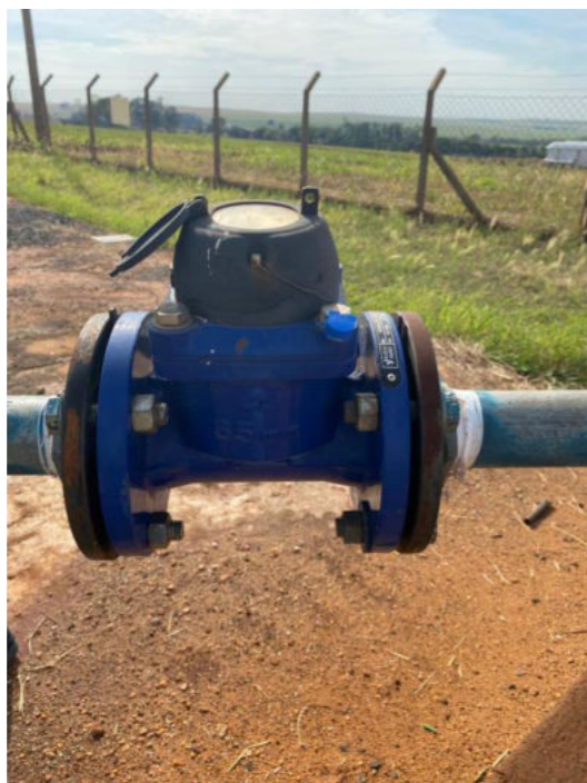
Figura 63 – Macromedidor poço UP 11.
