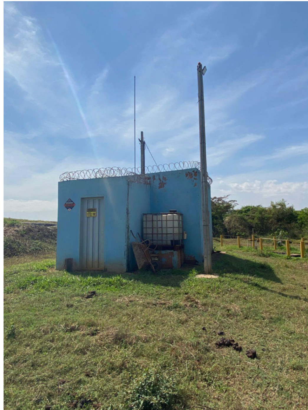
Figura 158 – Casa do Gerador.
