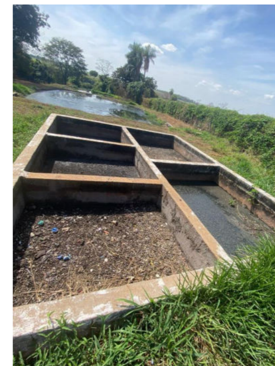
Figura 164 – Caixa de Recebimento de efluentes.
