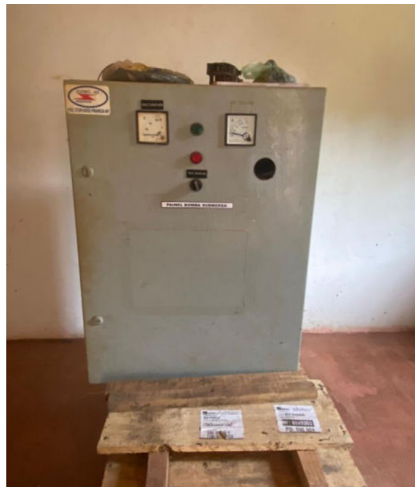
Figura 84 – Painel de controle.
