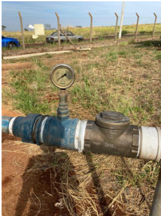
Figura 62 – Medidor de pressão – Poço UP 11.
