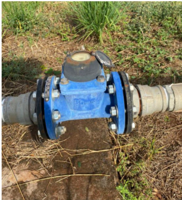
Figura 72 – Macromedidor poço UP 12.
