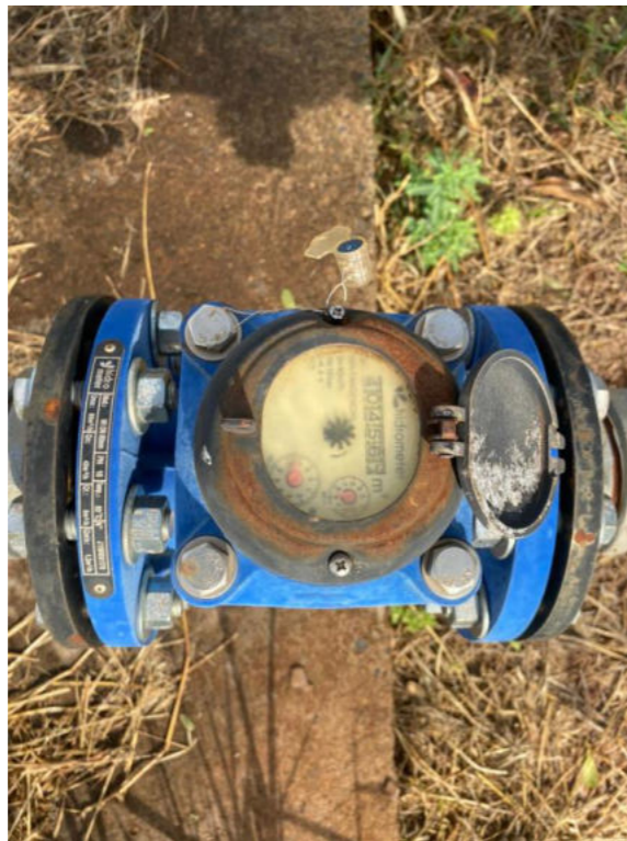
Figura 73 – Medição Macromedidor UP 12.
