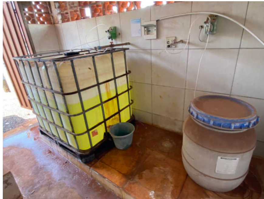
Figura 39 – Dosagem de cloro e flúor.
