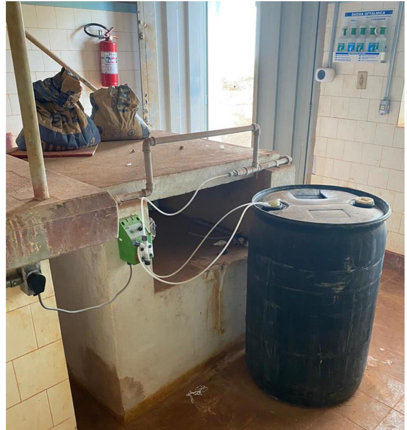
Figura 19 – Bomba dosadora de Flúor.
