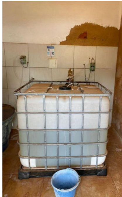
Figura 57 – Dosagem de cloro e flúor.
