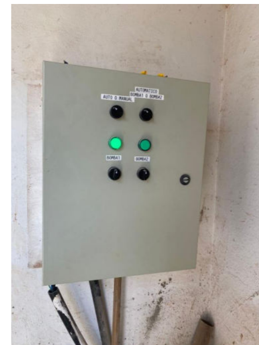
Figura 142 – Painel Elétrico da EEE Sete de Setembro.
