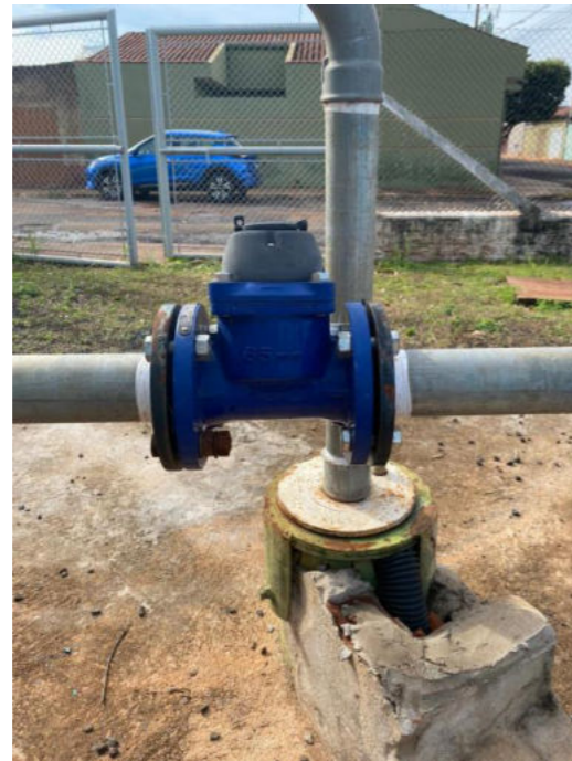
Figura 45 – Macromedidor poço UP 09.
