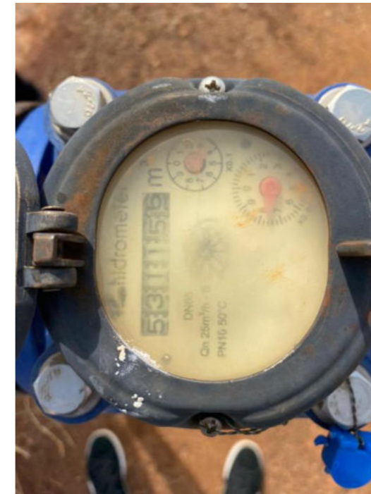
Figura 64 – Medição Macromedidor UP 11.
