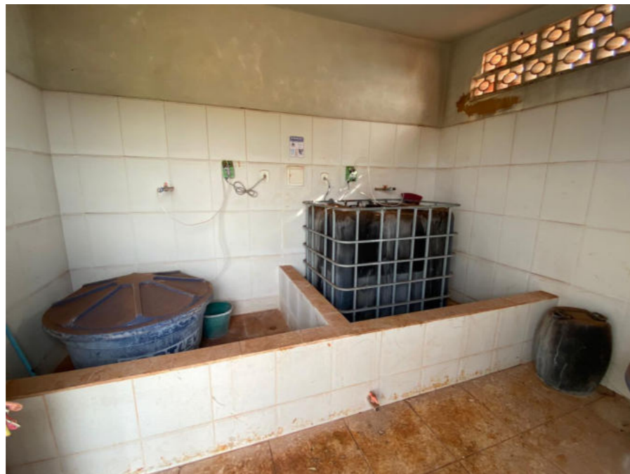
Figura 67 – Dosagem de cloro e flúor.
