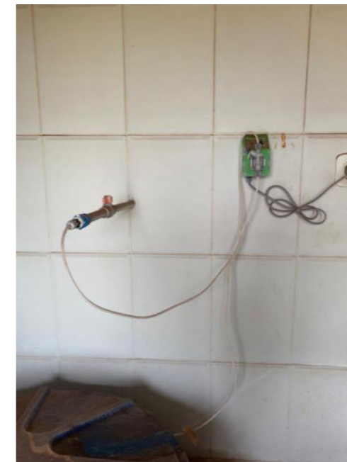
Figura 69 – Bomba dosadora de flúor.
