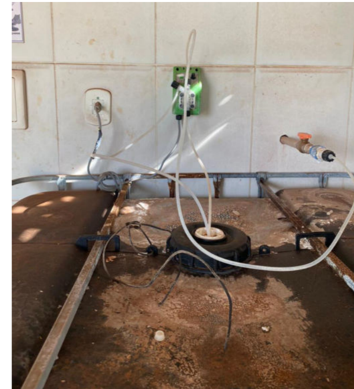
Figura 68 – Bomba dosadora de cloro.
