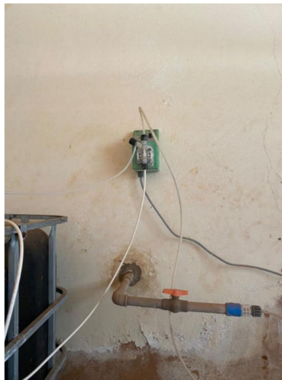
Figura 87 – Bomba dosadora de cloro.
