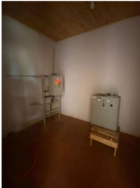
Figura 83 – Casa de máquinas.
