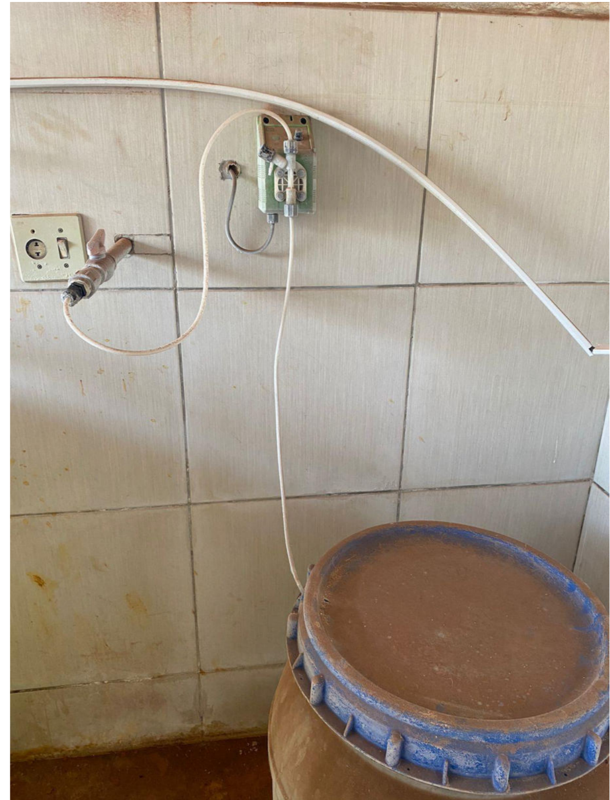
Figura 41 – Bomba dosadora de flúor.
