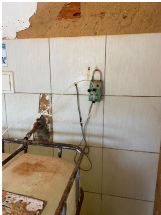
Figura 58 – Bomba dosadora de cloro.
