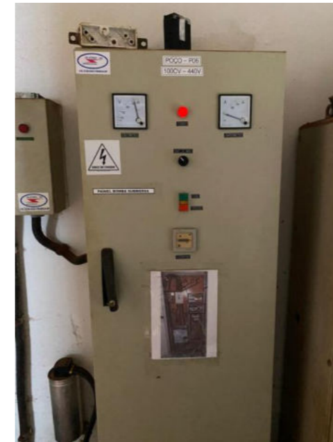
Figura 31 – Painel de comando.
