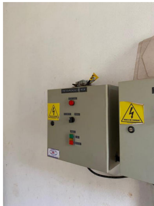
Figura 94 – Painel de comando.
