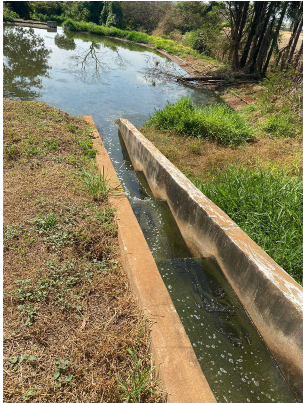
Figura 167 – Entrada do efluente na 2ª Lagoa Facultativa.
