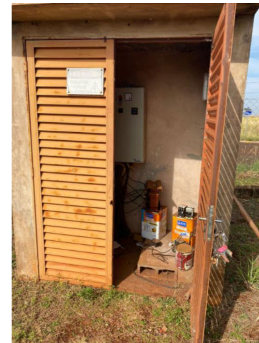
Figura 65 – Casa de máquinas.
