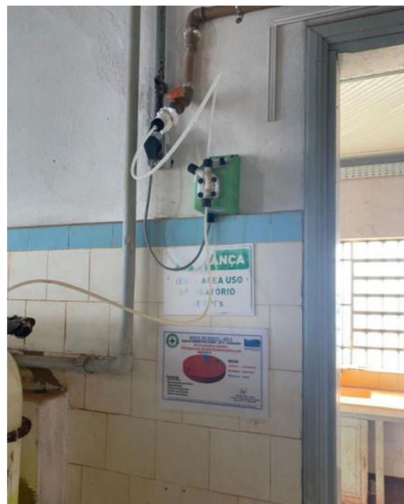
Figura 18 – Bomba dosadora de Cloro.
