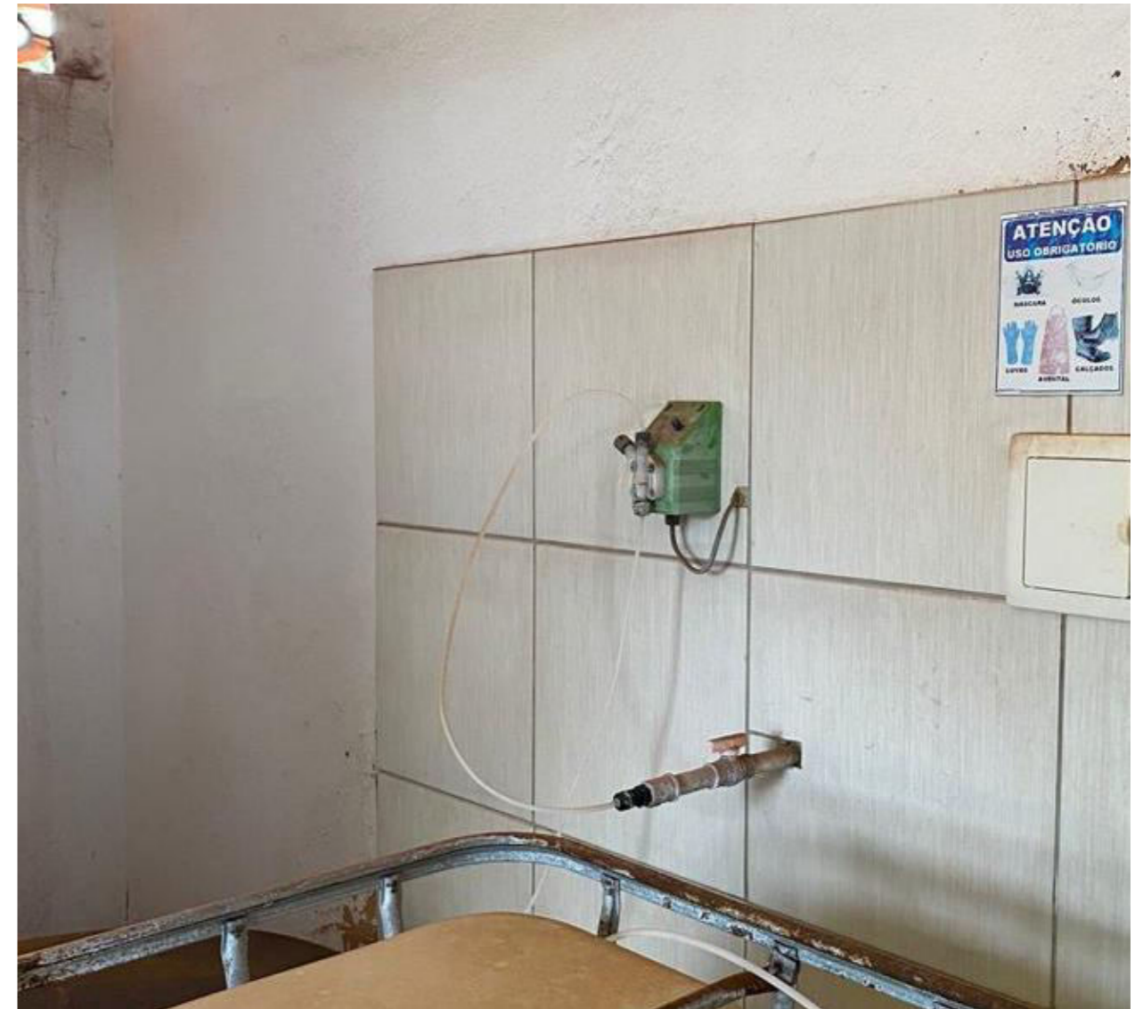
Figura 59 – Bomba dosadora de flúor.
