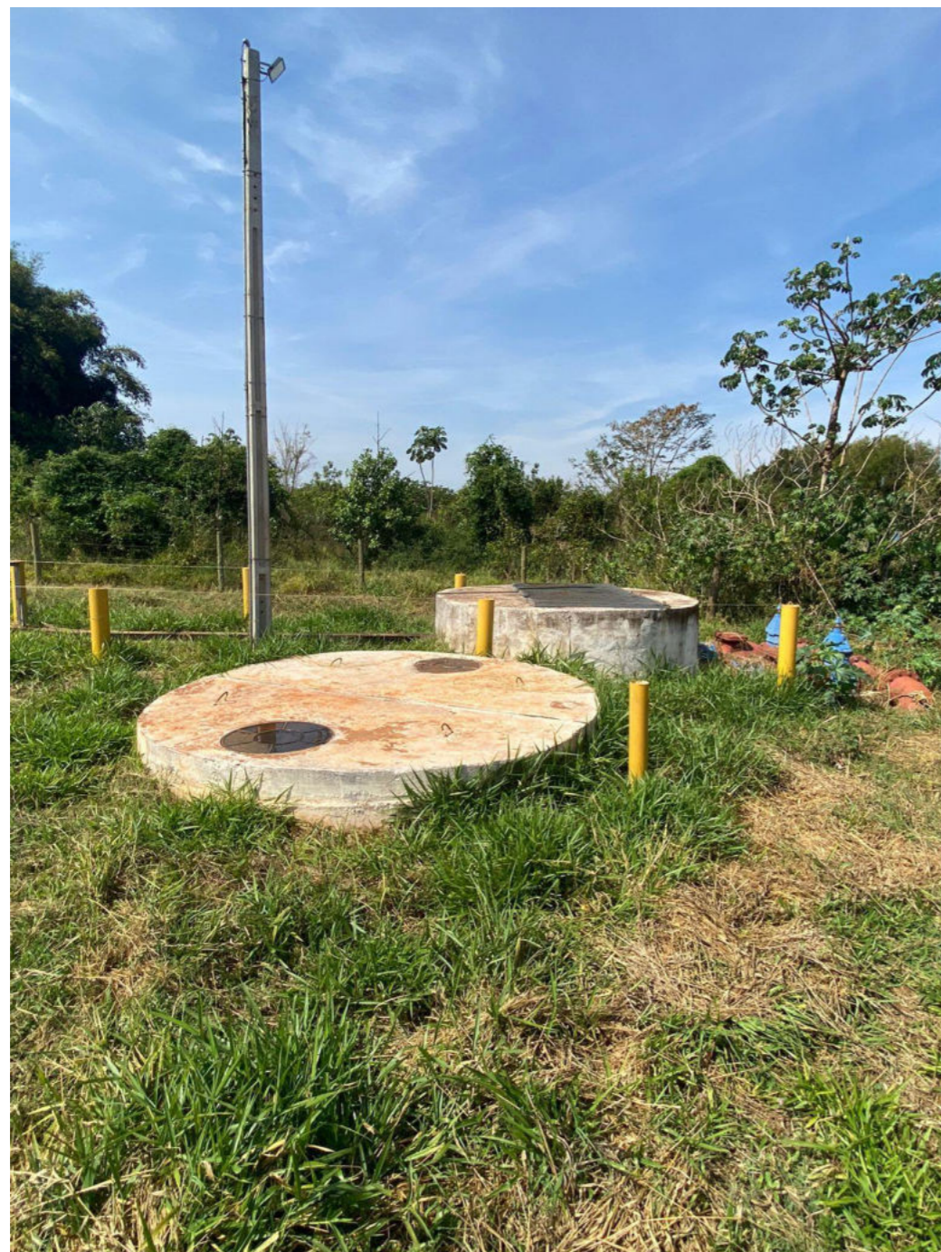
Figura 145 – Estação Elevatória de Esgoto da ETE Guará.
