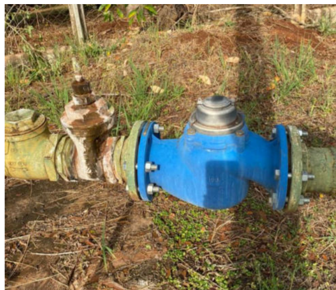
Figura 15 – Macromedidor Poço UP03.
