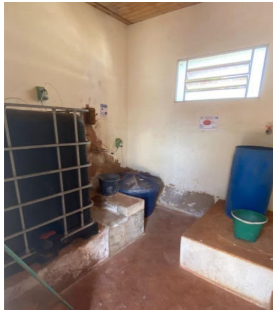
Figura 86 – Dosagem de cloro e flúor.
