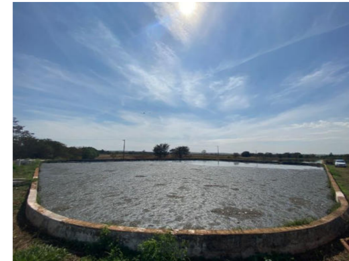
Figura 152 – Lagoa Anaeróbia (Parte 01)
