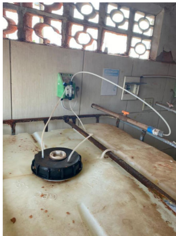
Figura 40 – Bomba dosadora de cloro.
