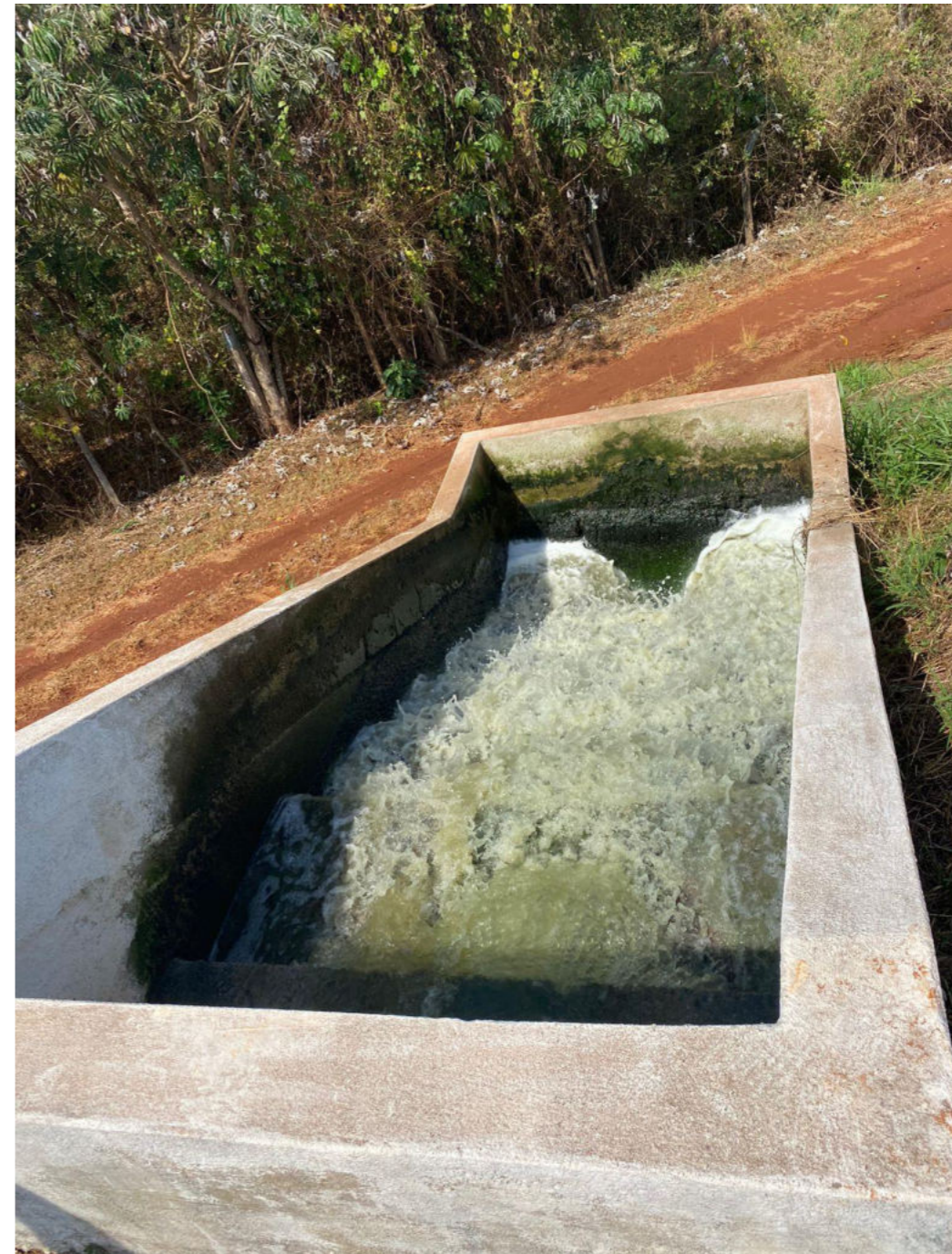
Figura 157 – Medição de Vazão na saída da ETE Guarú.
