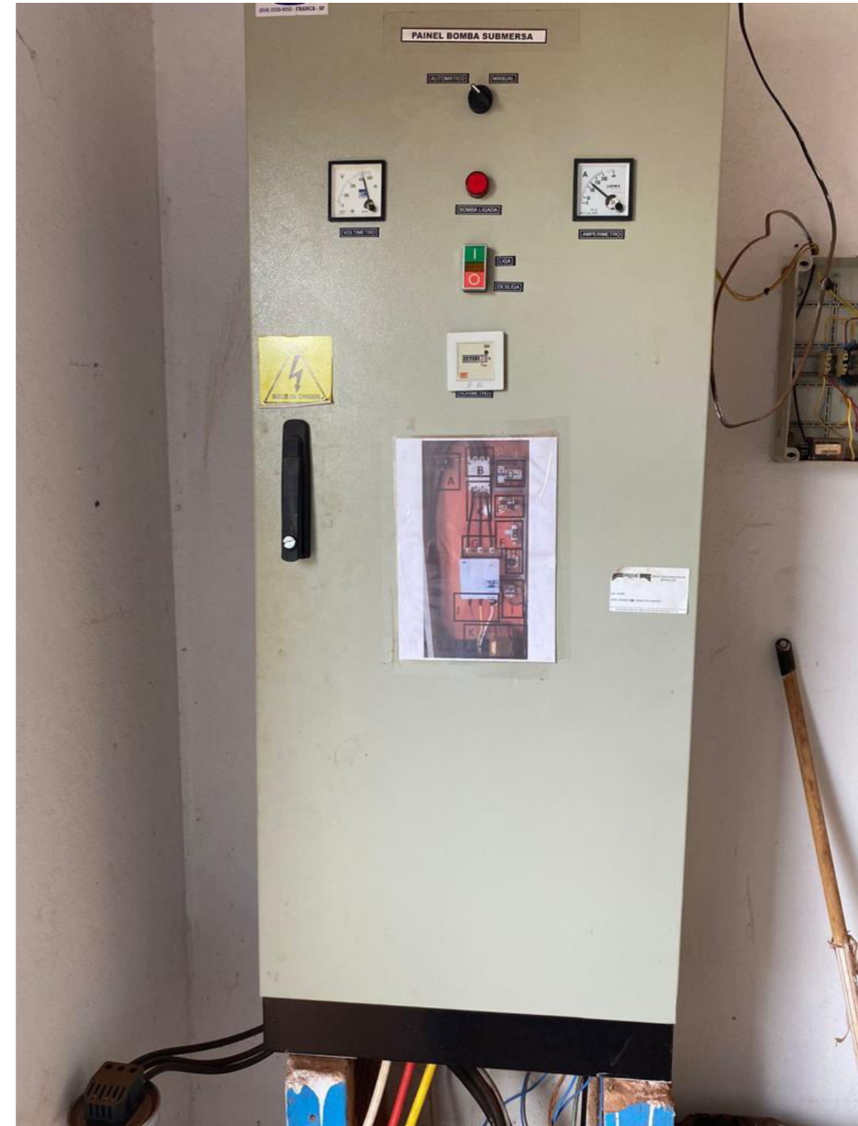
Figura 56 – Painel de comando.
