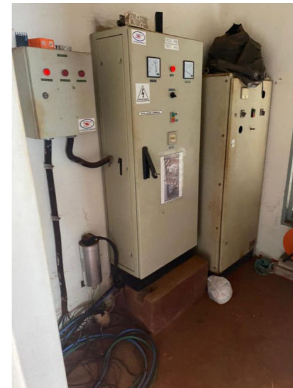
Figura 32 – Painéis de comando.
