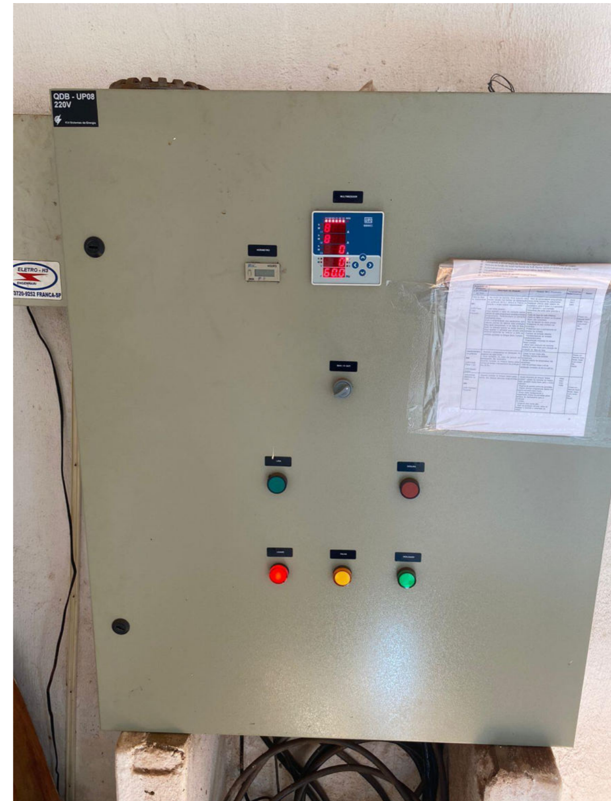
Figura 38 – Painel de Comando.
