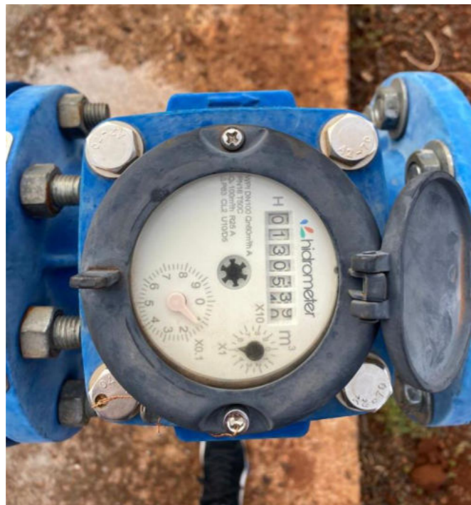
Figura 55 – Medição Macromedidor UP 10.
