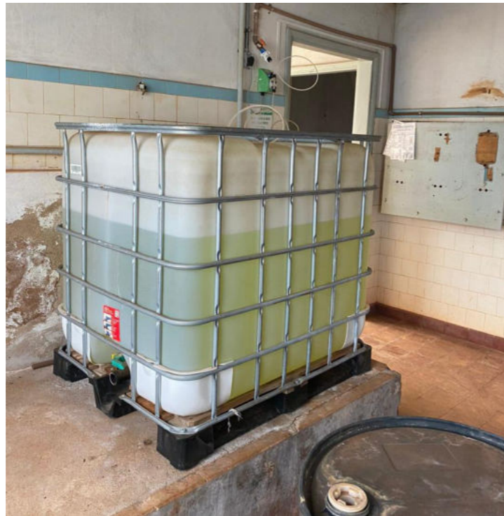
Figura 17 – Caixa de armazenamento de cloro.
