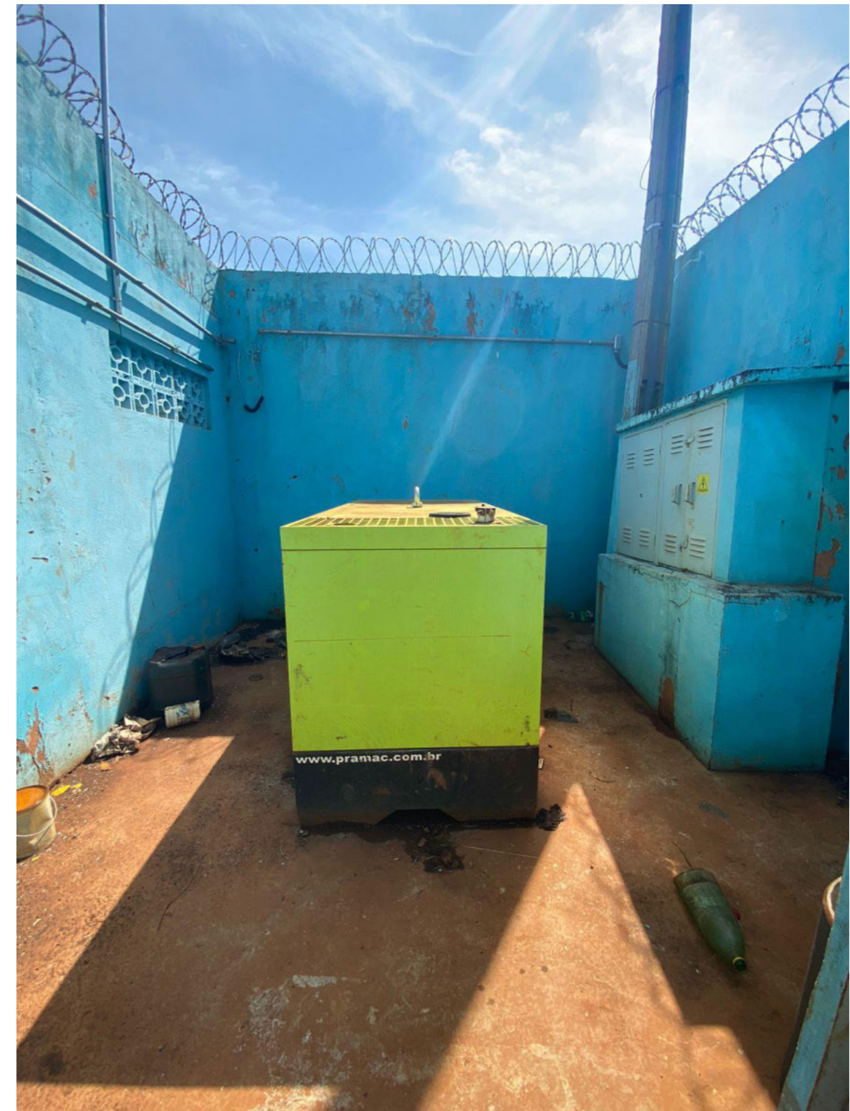
Figura 159 – Gerador de Energia.
