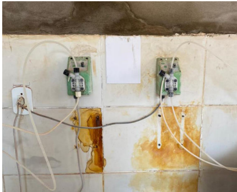
Figura 29 – Bombas dosadoras de cloro e flúor.
